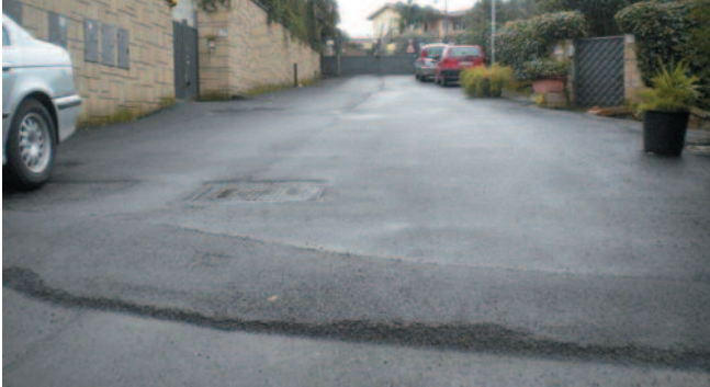
Via Cesare Bazzani - La "messa in sicurezza" con dossi... invisibili.
